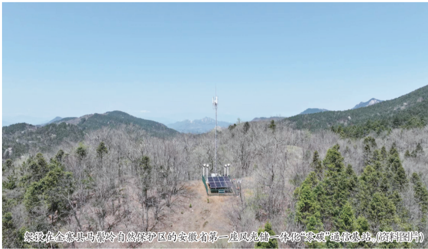
建设在金寨县马鬃岭自然保护区的安徽省首座风光储一体化“零碳”通信基站。(摄影图片)
