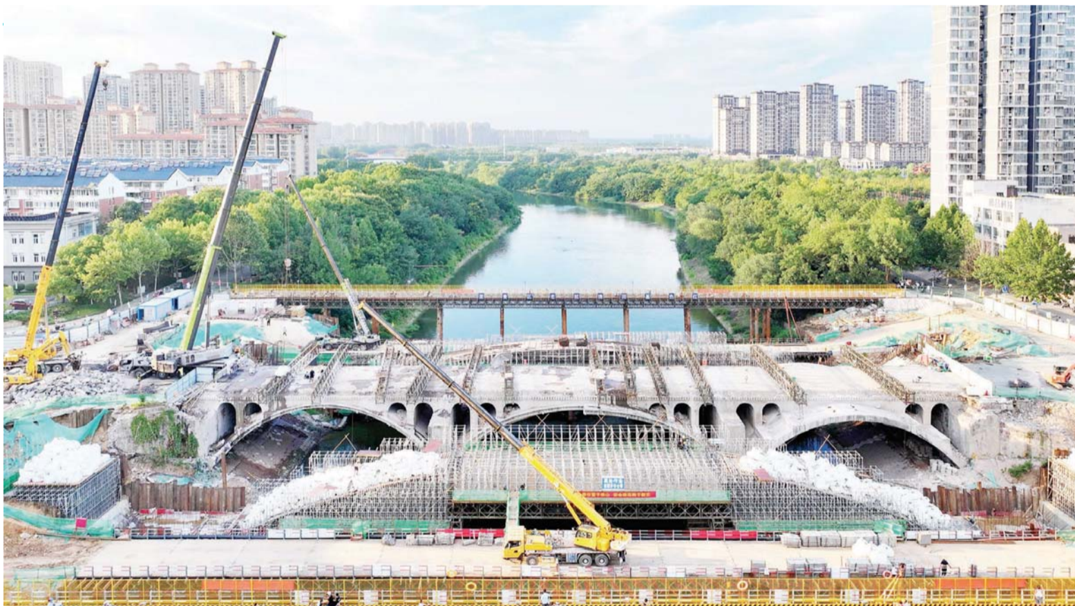
8月20日傍晚,六安城区五里墩大桥拆除重建工程施工现场,工人“干两头歇中间”避开高温,紧锣密鼓地进行老桥拆除施工。
