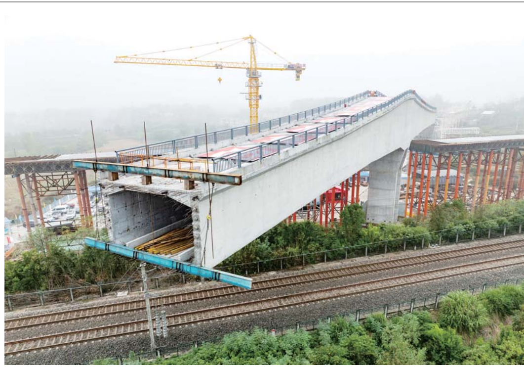
10月23日拍摄的湖北蕲春长胶廊道跨京九铁路连续梁转体作业现场(无人机照片)。当日,由中铁四局承建的湖北蕲春县长胶廊道上跨京九铁路大桥连续梁成功完成转体作业,为项目建成运营奠定基础。据悉,此次转体的连续梁长148米、重达9000吨。新华社记者 肖艺九 摄
