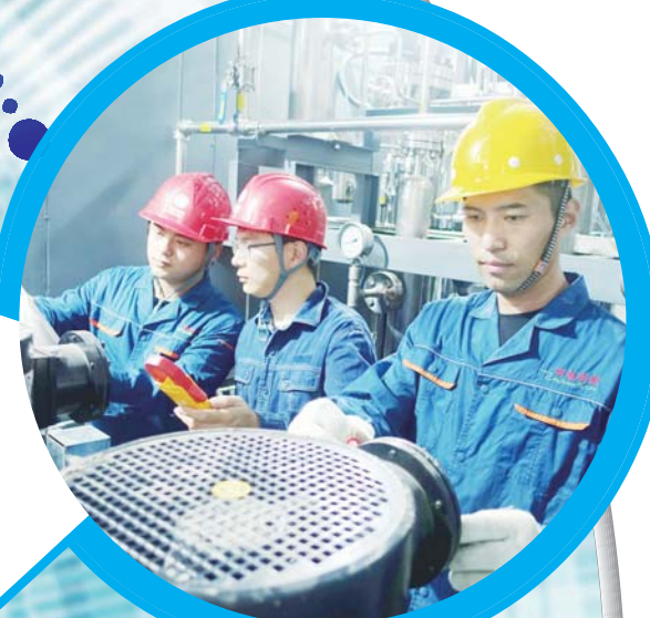
国网安徽六安供电公司、中科院大连化学物理研究所技术人员在位于我市的兆瓦级氢能综合利用站，对全国首套兆瓦级制氢系统进行联调试验。
