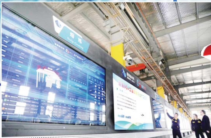
安徽省瀚海新材料股份有限公司技术人员在5G生产监控平台车间数据可视化看板上，监测设备运行情况。
