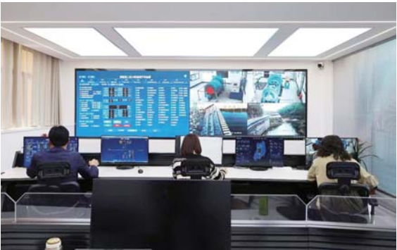
霍山县小水电集控中心
