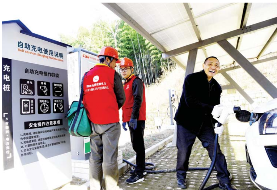
2021年12月29日，金寨县花石乡大湾村村民吴善喜(右一)在村光伏、充电一体化5G智能充电站为电动汽车充电。
