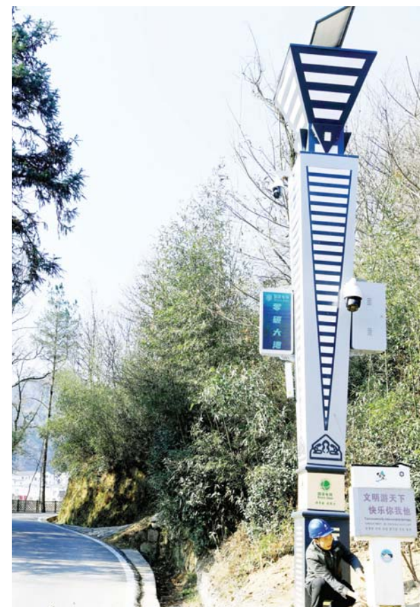
大湾村电力驿站的工人在检修村里的光伏智慧路灯。光伏智慧路灯实现太阳能发电、储能、安防监控、信息发布、应急广播、环境监测、智能管理等多功能于一体，有效降低公共设施能耗。
