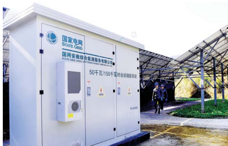
2021年12月29日，大湾村电力驿站的工人在村农光互补储能电站里巡查。光储一体电站促进清洁能源就地存储，实现区域内削峰填谷。
