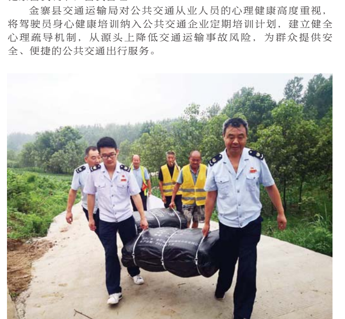
7月26日，霍邱县税务局党员防汛应急突击队搬运防汛物资，加固冯镇乡淮河防汛大堤。入汛以来，霍邱县税务局党委积极响应县委、县政府号召，坚持党旗引领，冲锋在前，迅速成立了一支党员防汛应急突击队，全力投入到大坝巡堤防汛中，在风雨中彰显霍邱税务的责任担当，用实际行动彰显初心、践行使命，构筑起一道坚不可摧的“蓝色”防线。
