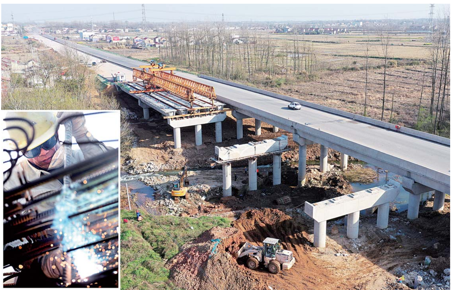
大图:3月14日,G312裕安区江家店镇段,施工单位在进行桥涵路基土石方回填。 小图:工人在焊接桥梁钢筋骨架。 本报记者 田凯平 摄
